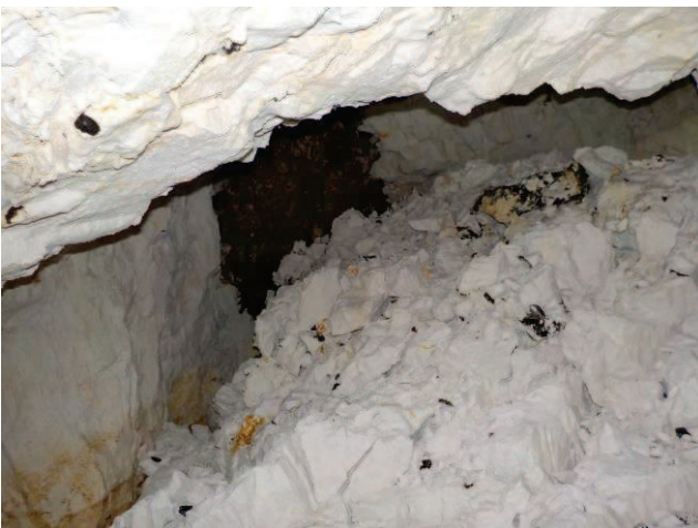
Photographie 5 : Galerie de marnière en partie comblée par l'effondrement du toit de marne
