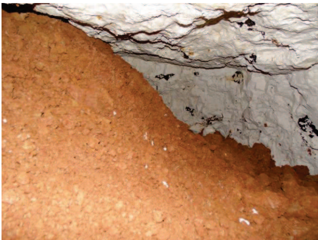
Photographie 9 : Effondrement à l'intérieur de l'ouvrage souterrain nécessitant des contre forages de contrôle
