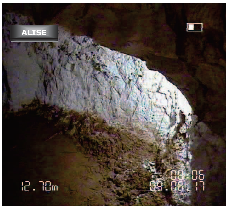
Passage caméra dans le forage SD2 de l'indice n°163 avec éclairage dans SD1 : vue sur les chambres d'exploitation (1/2)
