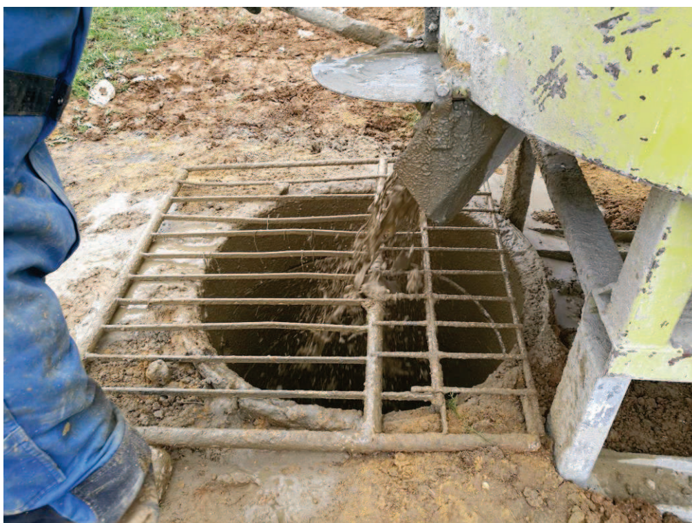
Photographie 4 : Illustration du comblement des cavités par un des puits
