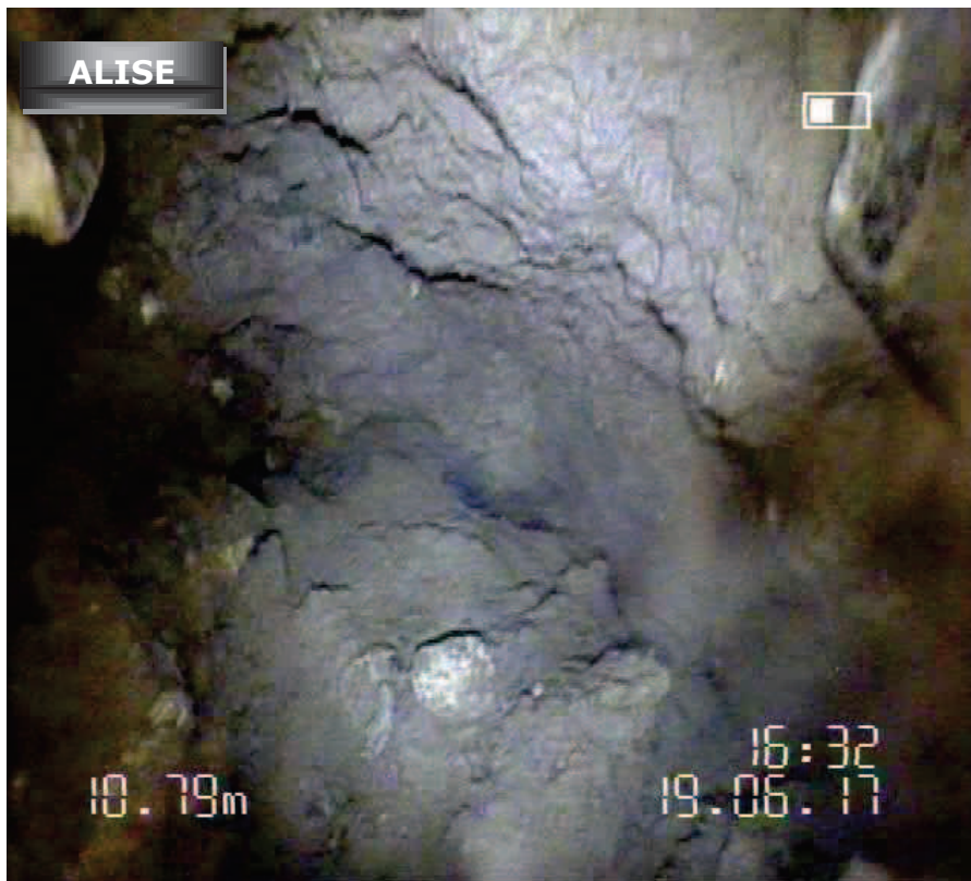
Passage caméra dans le forage SD3 de l'indice n°167: l'anomalie correspond à une poche de vide dans une racine d'argile à silex avec des effondrements
