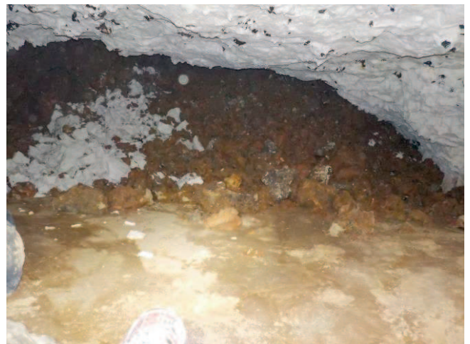
Photographie 6 : Effondrement des limons et de l'argile au sein de l'ouvrage. Nécessité de vérifier l'absence de galerie au-delà de l'effondrement
