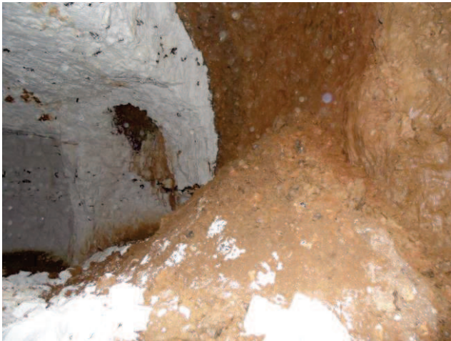
Photographie 11 : Racine d'argile de taille importante fragilisant l'ouvrage souterrain
