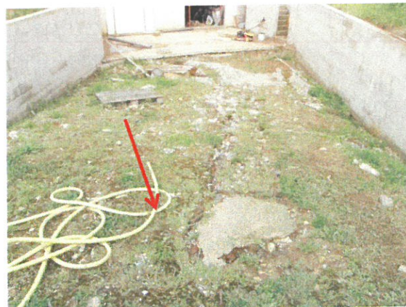
Photographie 2 : Ravine dans la descente de garage vers l'effondrement autour du puisard
