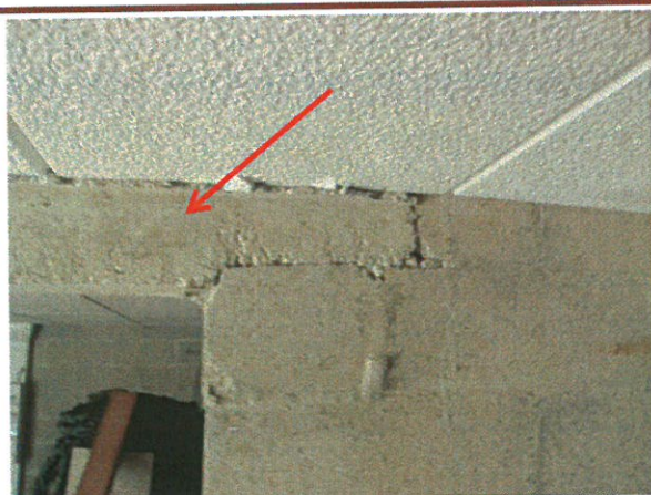
Photographie 15 : Linteau impacté dans le garage
