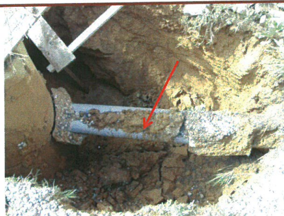
Photographie 4 : Canalisations d'eaux pluviales (gouttières...) reliées au puisard
