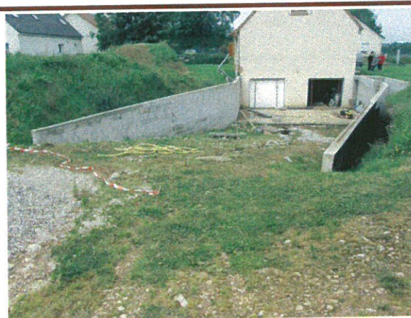
Photographie 24 : La propriété le 26 mai avec l'effondrement en façade Est
