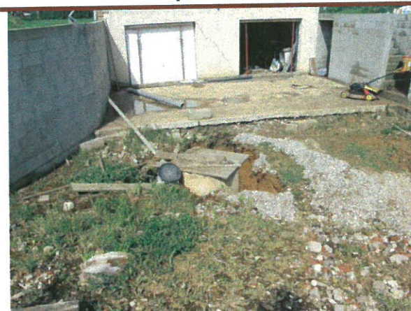
Photographie 6 : vue sur le site, avec puisard et maison étayée
