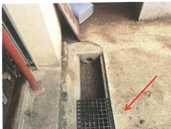
Photographie 8 : Fissure de la terrasse au niveau du regard de récupération des eaux pluviales
