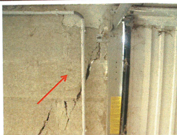
Photographie 17 : Mur fissuré depuis l'intérieur du bâti (sous-sol, façade Est) jusqu'au linteau de la porte de garage
