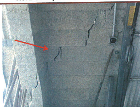
Photographie 16 : Mur fissuré depuis l'intérieur du bâti au sous-sol, façade Est
