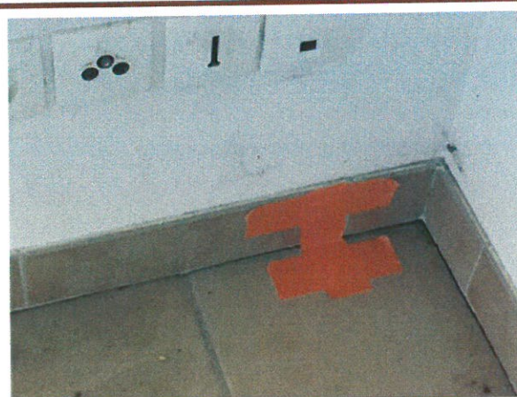
Photographie 18 : Décollement de la plinthe et du carrelage dans la salle à manger (façade Est)
