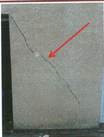
Photographie 9 : Fissure le 24 mai
