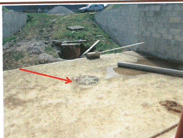
Photographie 5 : avaloir dirigeant les eaux pluviales de la terrasse vers le puisard
