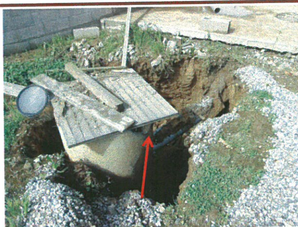
Photographie 3 : Effondrement autour du puisard
