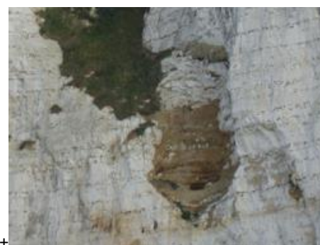
Karst obstrué visible sur la falaise
