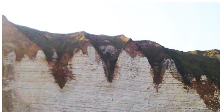
Vue de face sur la falaise côtière, sur une « coupe fraîche » après effondrement d'un pan de falaise (Saint-Martin-aux-Buneaux – Crédit photo : explor-e)
