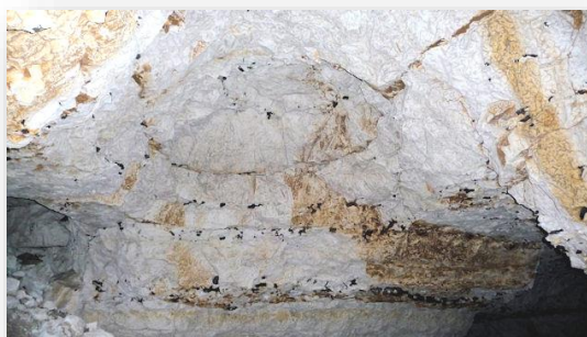
Ci-dessus : formation d'une cloche de fontis au ciel d'une carrière souterraine (marnière).
