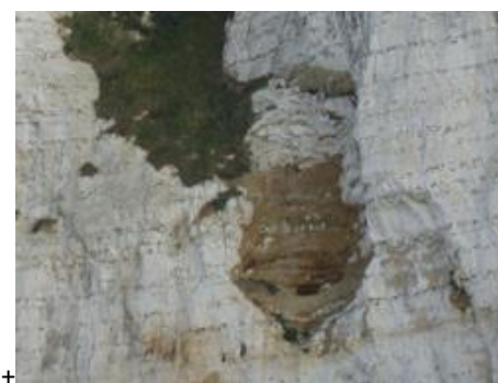
Karst obstrué visible sur la falaise
