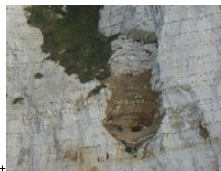
Karst obstrué visible sur la falaise
