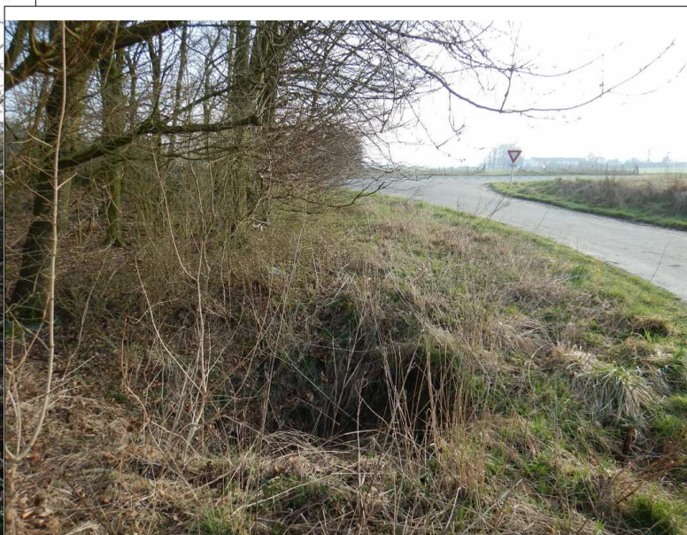
3. Illustration: Effondrement dans l'accotement de la voie de service
